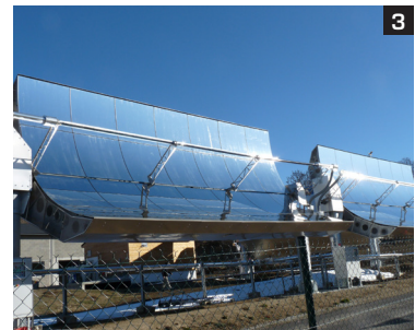
3 La microcentrale solaire de 150 kW (thermique) à Odeillo-Font Romeu.
